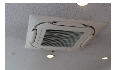
▲空調設備更新後
