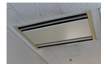
▲空調設備更新前
