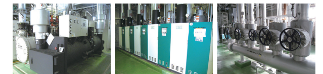
▲高効率ターボ冷凍機 ▲高効率貫流ボイラー ▲蒸気バルブ断熱ジャケット
