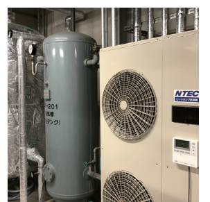
▲〔デザート工場〕給湯設備エコキュート
