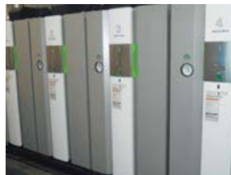
▲小型貫流蒸気ボイラー
