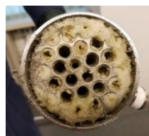
エミール未設置： 熱交換器出口側がスケールで閉塞している
