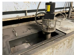
オイルスキマーは脱脂洗浄工程の前処理槽の横に設置している。
