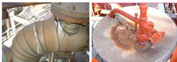
図 3-1 保温材下腐食 (CUI)
