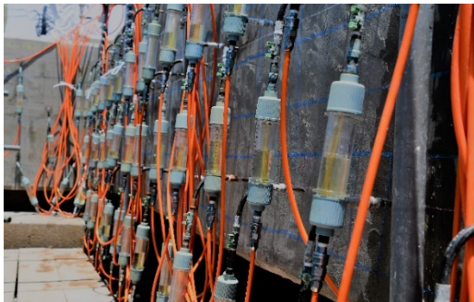
(写真4)コンクリートの亀裂に薬液を圧入作業中 (赤いチューブはコンプレッサーに繋がっている) [福徳技研(株)提供]
