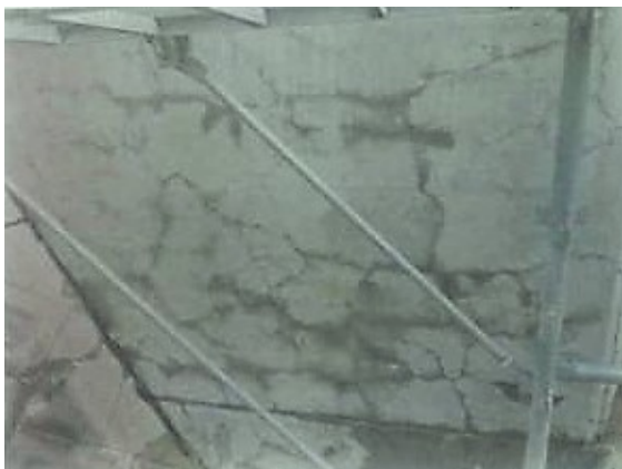
(写真2)細かく亀裂の生じている橋脚台座 [福徳技研(株)提供]
