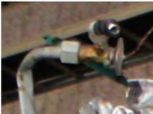
写真-4.32 エアコン配管類
