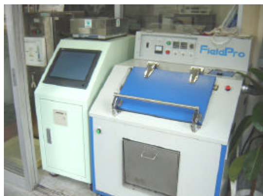
3号館の生ごみ処理機発砲スチロール処理機
