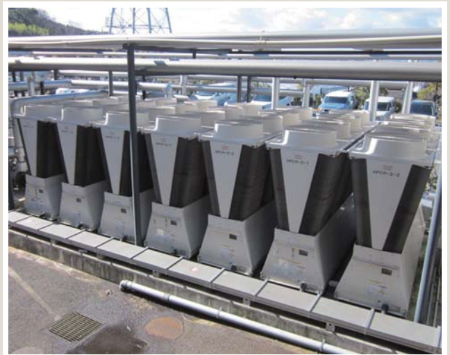
▲導入したモジュール型の空気熱源ヒートポンプチラー
