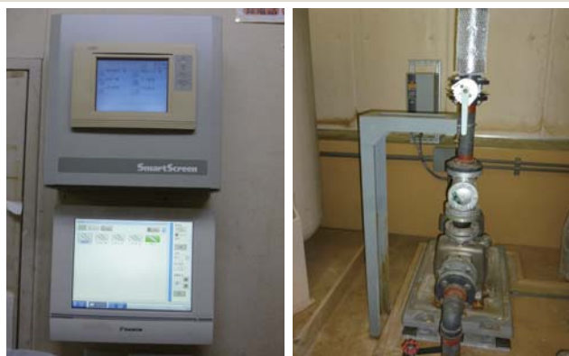
▲導入したBEMS(左)及び一定時間の停止を行っている循環ポンプ(右)
